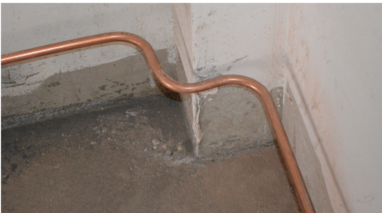
Equipotential grounding conductor
